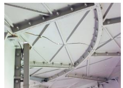
Scheuren in de gietijzeren vloerdelen.
