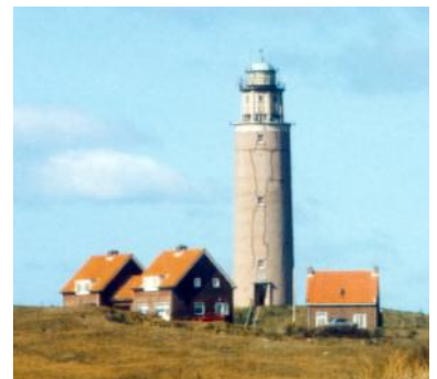
Het vuurtoren begin jaren negentig, met gerepareerde scheuren in de mantel.
