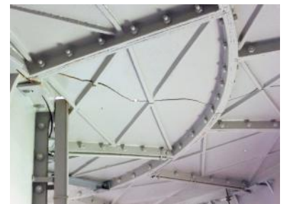
Scheuren in de gietijzeren vloerdelen.
