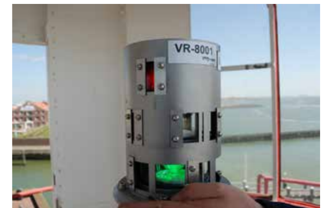
Het in 2013 geplaatste led-armatuur in het havenlicht.
