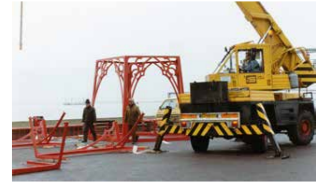
December 1989: de firma Van der Straaten is bezig met de opbouw van het nieuwe onderstel van het havenlicht.
