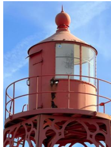
Het lichthuis uit 1907 bevindt zich momenteel in slechte staat.
