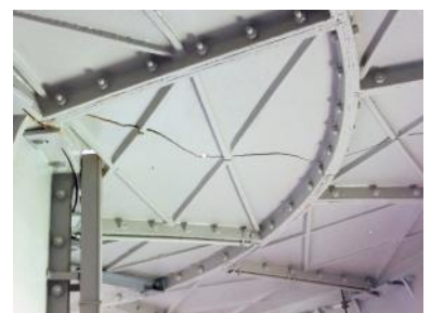
Scheuren in de gietijzeren vloerdelen.
