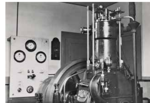
De machinekamer met daarin de Bronsmotor met dynamo.
