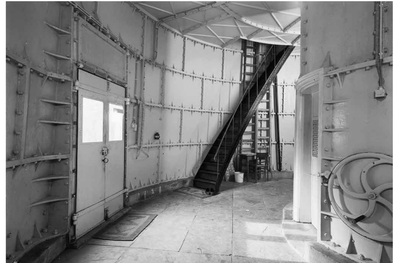
Het interieur van de vuurtoren in 1976. De gietijzeren elementen zijn met talloze moerbouten aan elkaar bevestigd.
