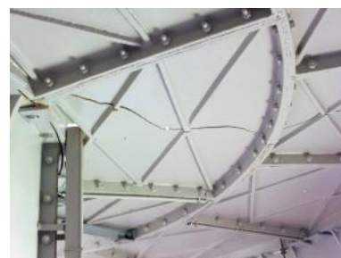
Scheuren in de gietijzeren vloerdelen.
