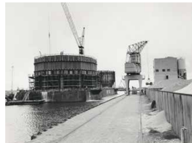
De werkhaven van Katseveer op 12 april 1973. De caissons voor de havenlichten werden op pontons opgebouwd, met betonstort.
